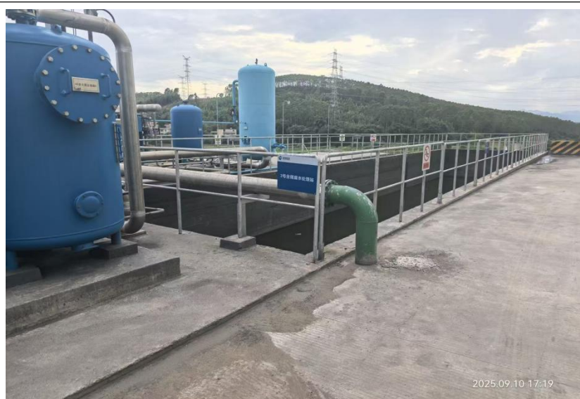
含煤废水处理设施（一套处理能力为 20\text{m}^3/\text{h} ）
