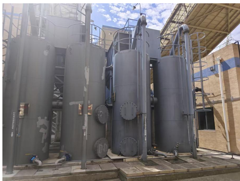
工业废水处理设施（一套处理能力为 50t/h）
