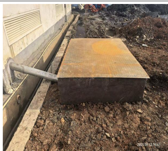
危废仓（应急池）
