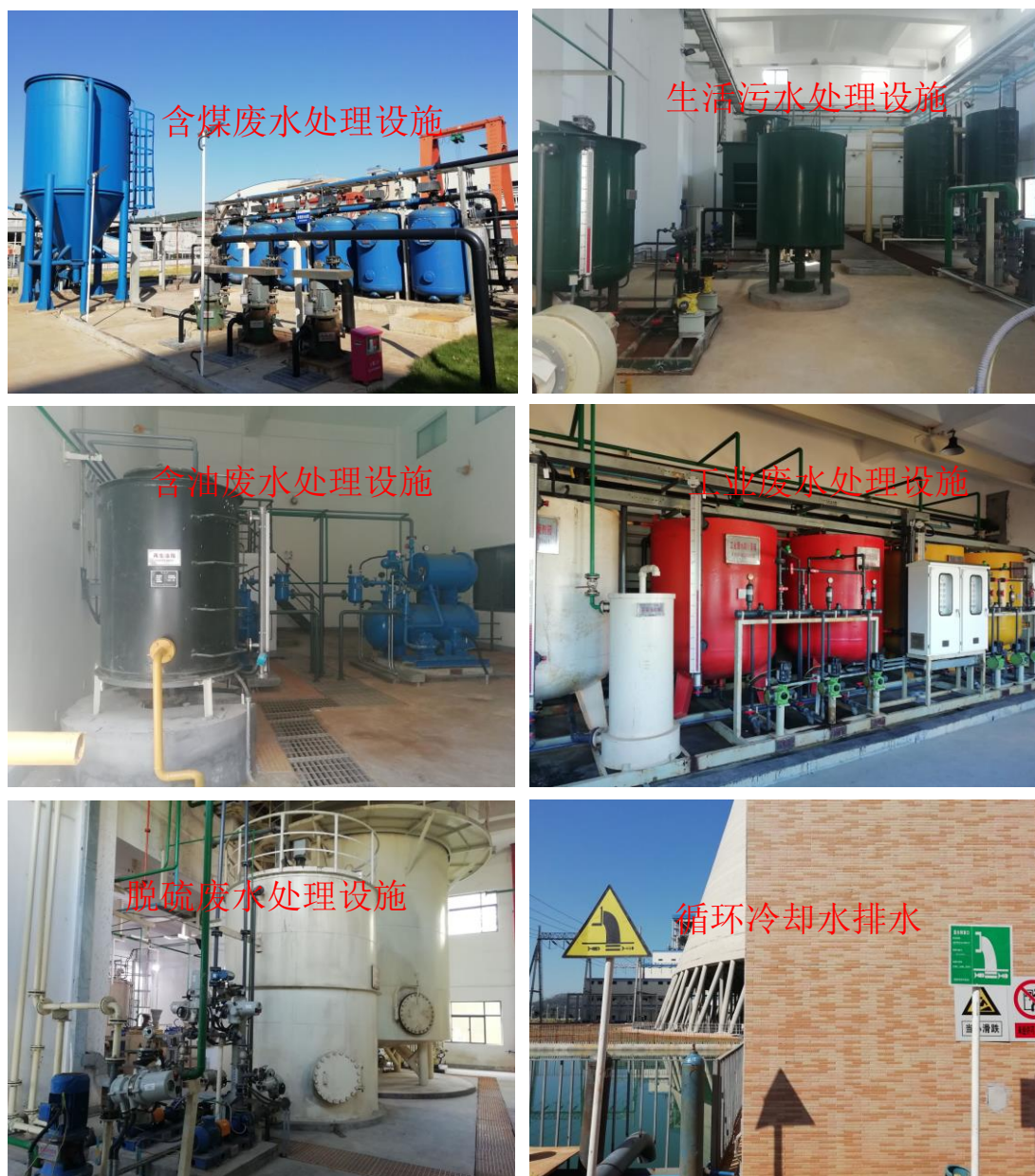
图 4-6 废水处理设施
