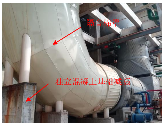
引风机降噪措施
