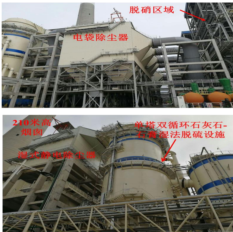
图 4-2 废气主要环保设施
