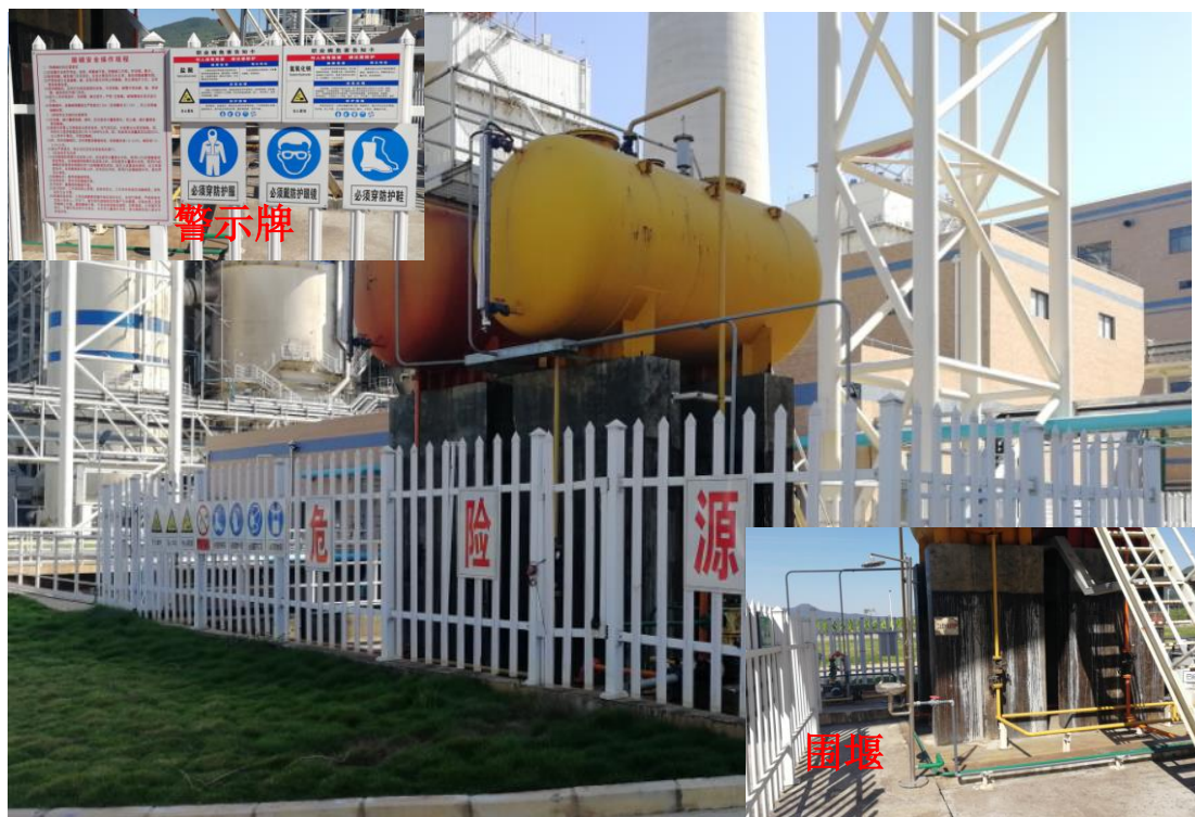
图 9-10 废水处理区域酸碱贮存罐
